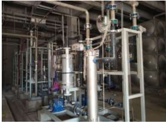
鍋爐補給水系統脫氣膜裝置
