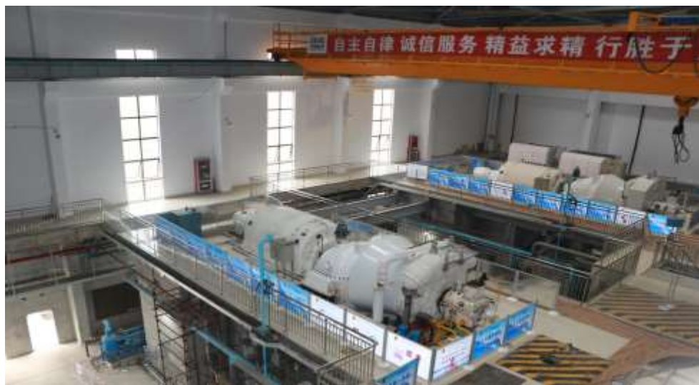
汽機房 7 米運轉層
