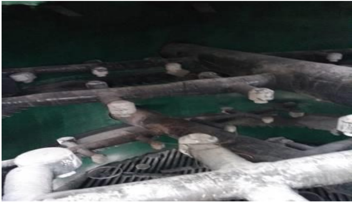
脫硫除噴淋管道
